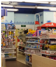
Захламление выхода эвакуации
